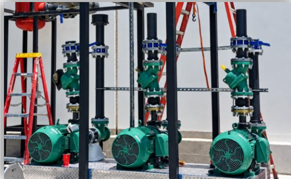
BOMBAS DE CENTRIFUGACIÓN
