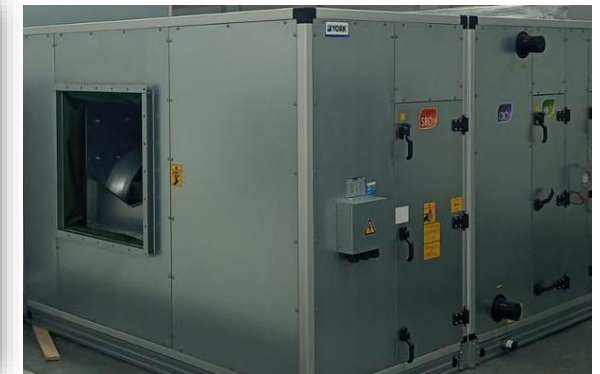
MANEJADORA DE AÍRE (AHU)
