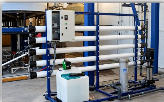
SISTEMA DE OSMOSIS
