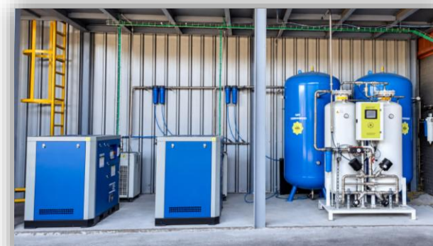
SISTEMA DE NITRÓGENO
