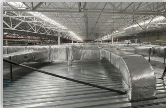
RED DE DUCTOS HVAC AISLADOS
