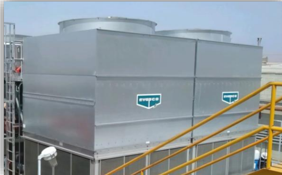
TORRES DE ENFRIAMIENTO
