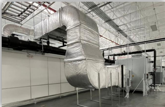
DUCTERIA DE DISTRIBUCIÓN DE AIRE
