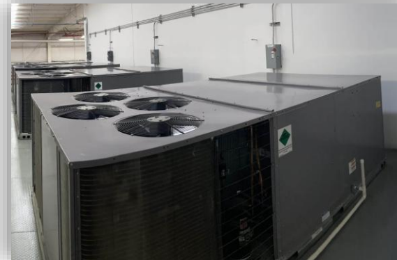
CONDENSADORAS DE AIRE FRÍO
